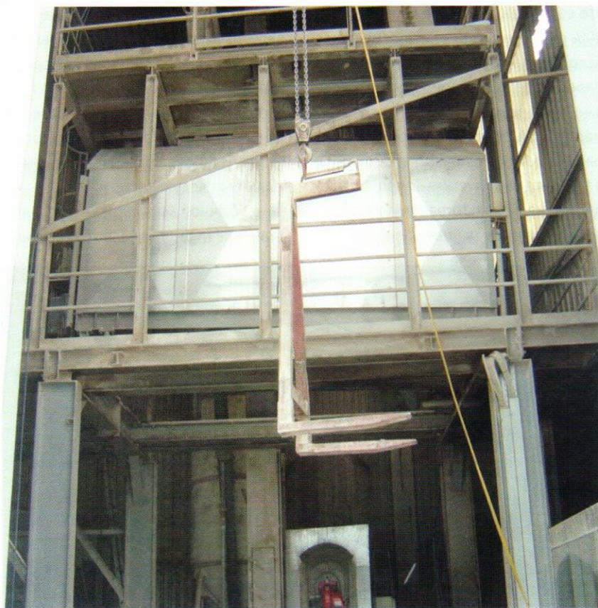
Фото 2. Стационарный кохер в составе обычной асфальтосмесительной установки
